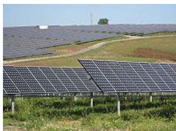
Slika 2: Solarna elektrana Serpa u Portugalu snage 11 MW
